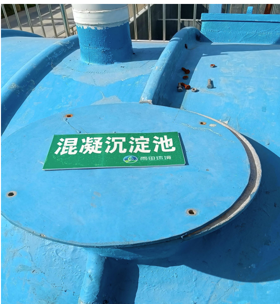
污水处理站（混凝沉淀池）
