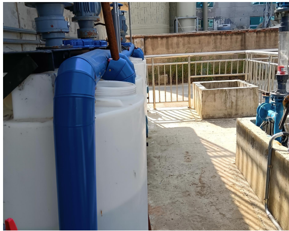
污水处理站（调节池）
