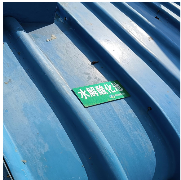
污水处理站（水解酸化池）
